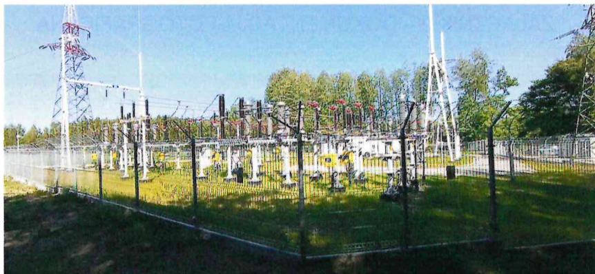
Otoczenie rozdzielni sieciowej RS Kity
