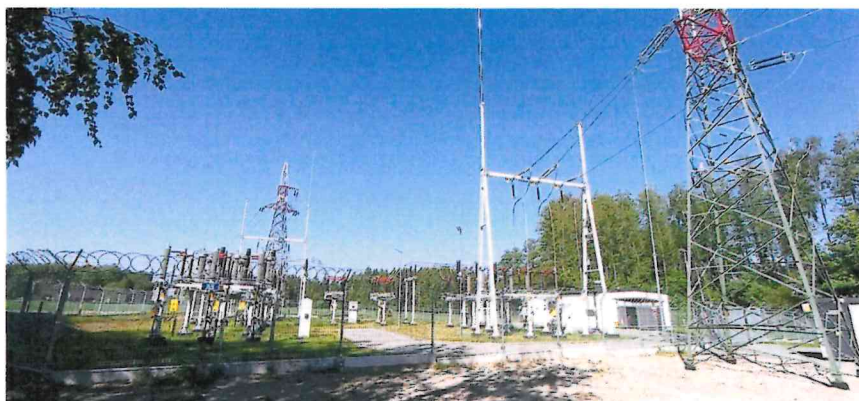
Rozdzielnia sieciowa 110 kV RS Kity. Widok od strony słupa 46
