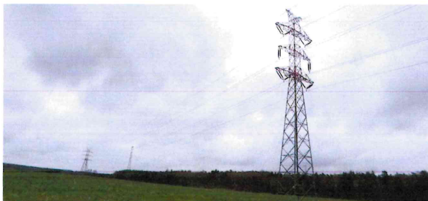
Przęsło 33A – 32A linii 110 kV RS Racibory – Wysokie Mazowieckie / Łapy
