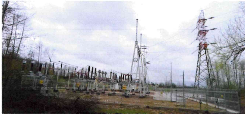
Rozdzielnia sieciowa 110 kV RS Racibory. Widok od strony słupa 34A
